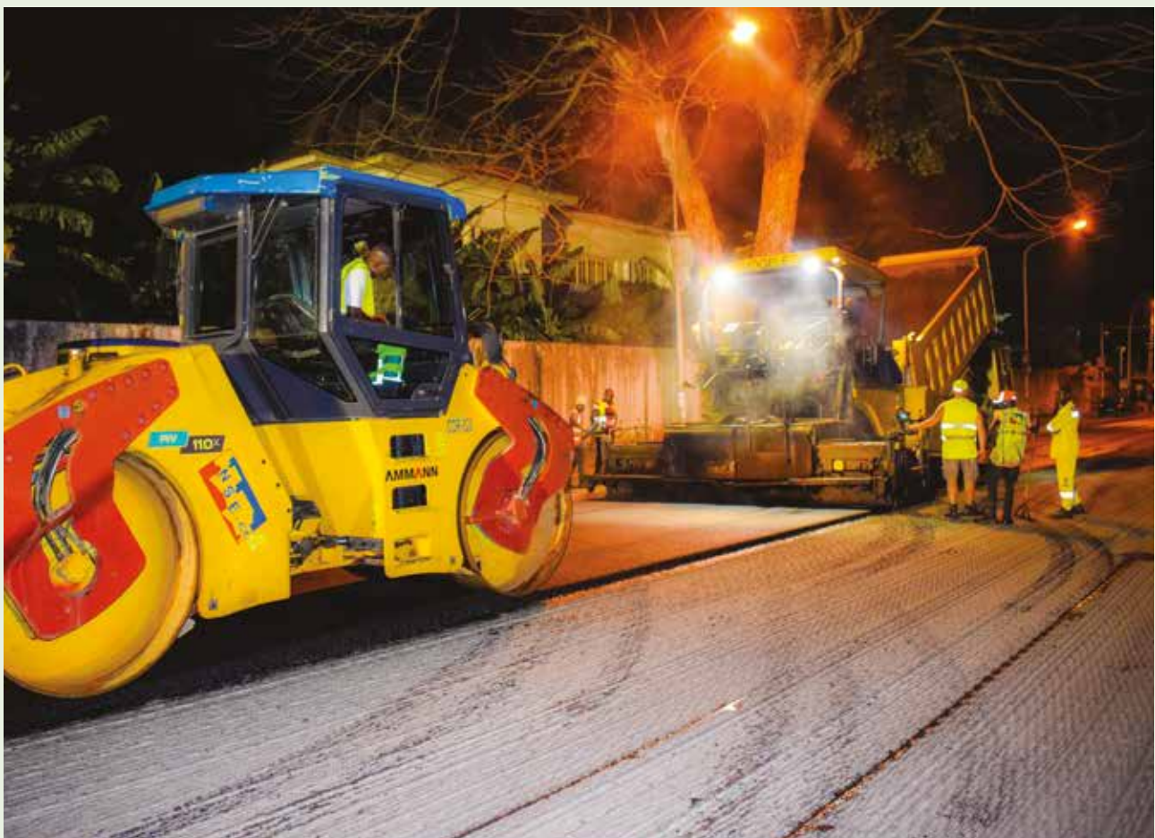
Après le rabotage de la route et son nettoyage pour la débarrasser de la poussière, suit l'application des enrobés ( Photo : DR)
