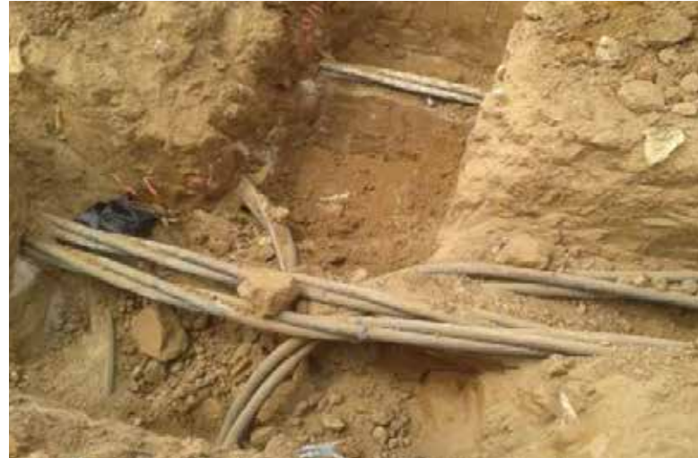
Réseaux électriques à déplacer
